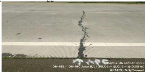
Gambar 4 Kerusakan Transversal crack KM 108+185 – 108+180 Jalur B/L1
